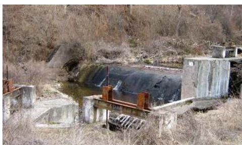
Тиролски зафат „Бошавски канал“
